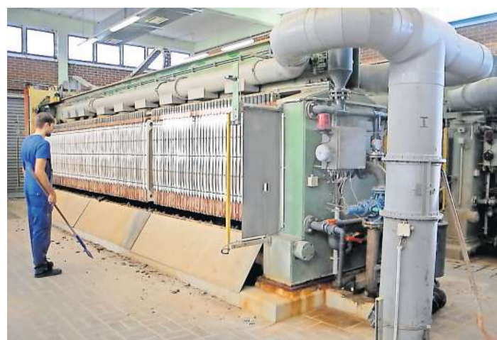
In einer Kammerfilterpresse wie hier in Hameln wird der Klärschlamm entwässert.
